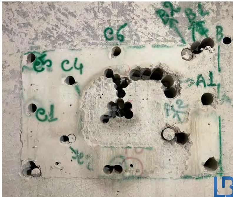
Figura 8 – Stato della parete frontale a seguito dei carotaggi
