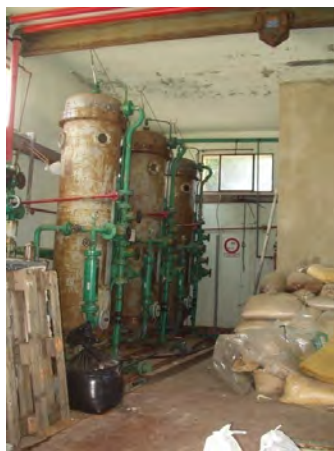
Fig. 3: Impianto di decationizzazione e circuito secondario
